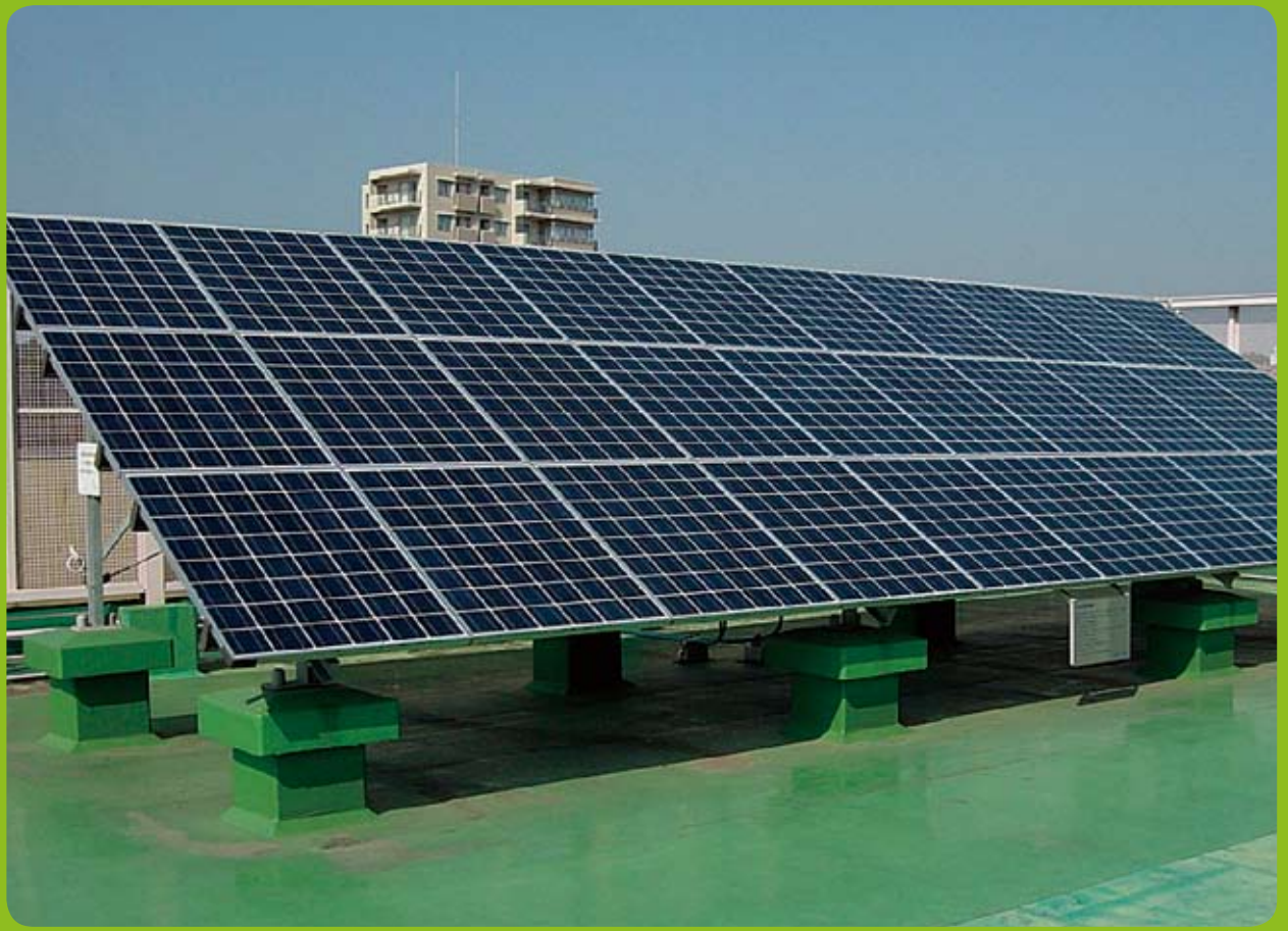
麻生区役所屋上に設置された太陽電池パネル
