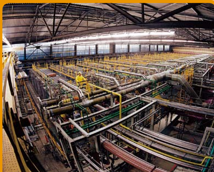
ドイツ BASF 社で稼働中の苛性ソーダ生産設備。
