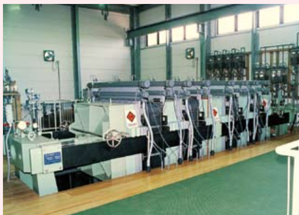
伊豆大島の海水淡水化装置 毎日 4500m 3 の飲料水を供給しています。
