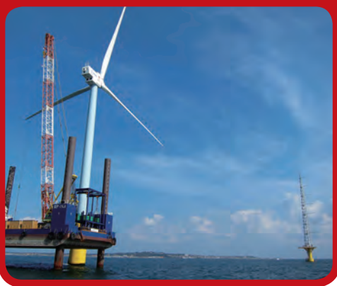
沖合洋上風車と観測タワー (千葉県銚子市の沖合約3kmに設置)
