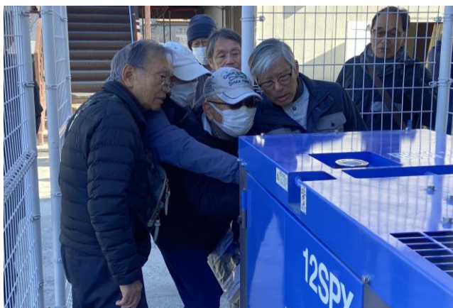
避難所運営委員による発電機作動確認
